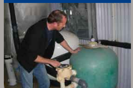
Philippe Aublanc : « Les installations sont alimentées en eau de mer naturelle filtrée par plusieurs processus mécaniques et biologiques. »
